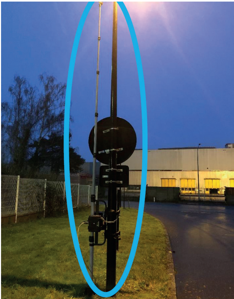
Figure 193 : Exemple de mât de comptage
